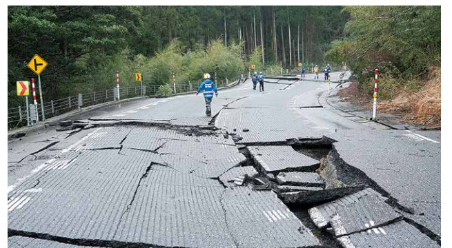
国道249号、輪島市稲舟町付近、1月18日撮影。出典:国土交通省ウェブサイト https://www.mlit.go.jp/road/road_fr4_000151.html
