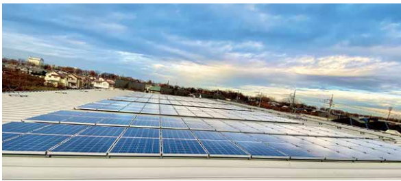
水道局施設の屋根に設置された太陽光パネル(国分寺市北町)
